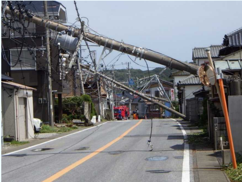
電柱倒壊で道路が封鎖（館山市船形）
